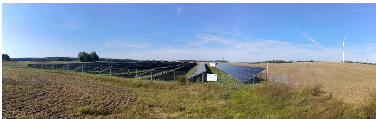
Fot. 10. Widok w kierunku zachodnim na farmę fotowoltaiczną zlokalizowaną we wschodniej części obszaru projektu „Planu...” w obrębie Drzonowo, w tle po prawej elektrownie wiatrowe w otoczeniu
