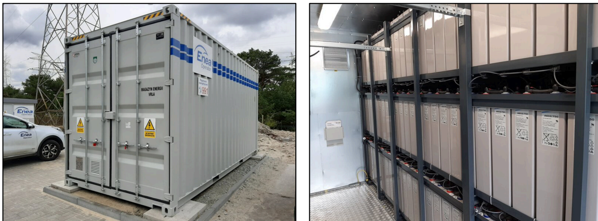
Rycina 46 Przykładowy magazyn energii, po lewej wygląd z zewnątrz, a po prawej wewnątrz (źródło: ENEA S.A. – materiały prasowe)
