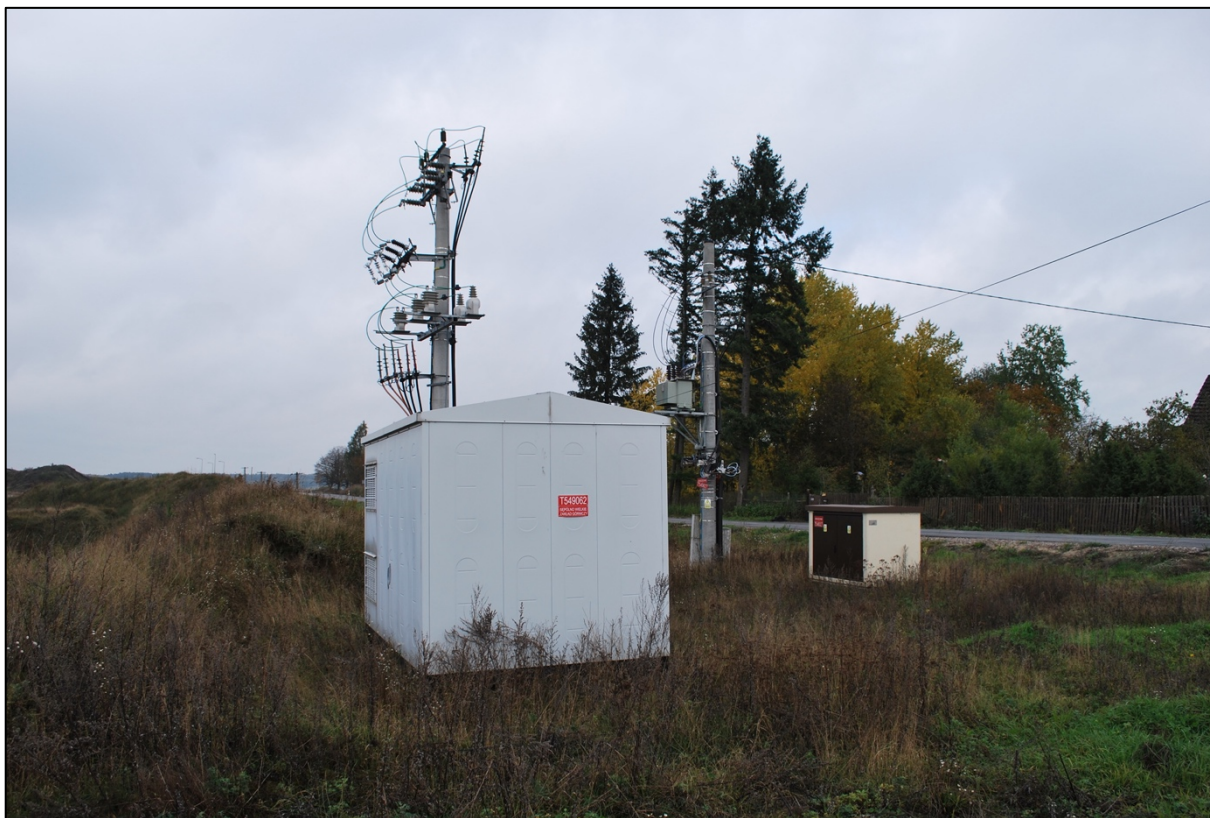
Rycina 8 Transformatory nn/SN przy drodze powiatowej w sąsiedztwie terenu południowego planowanej inwestycji (fot. M. Roszyk)
