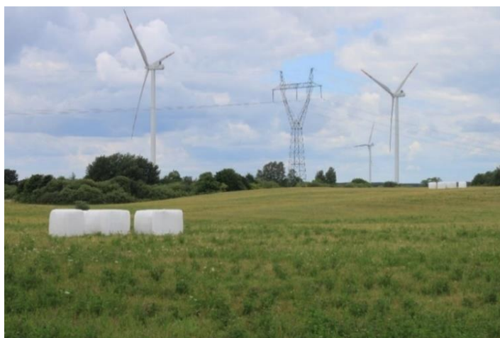
Fot. 28. Linia ee 220 kV w otoczeniu elektrowni wiatrowych
