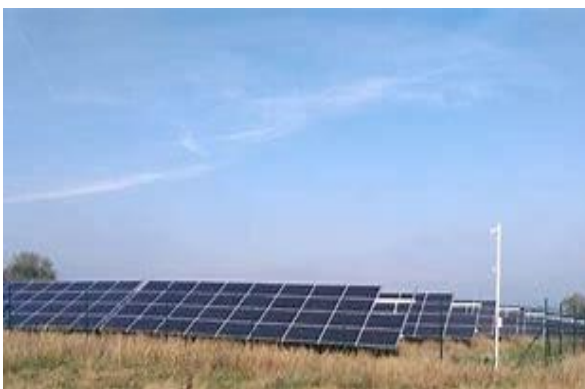
Fot. 35. Widok farmy fotowoltaicznej na terenie równinnym z kilkunastu m
