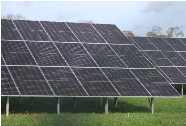
Fot. 1. Farma fotowoltaiczna z pionowym układem paneli – widok z bliska
