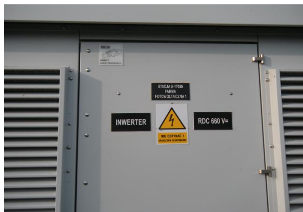
Fot.4. Kontener: inwerter RDC 660 V=
