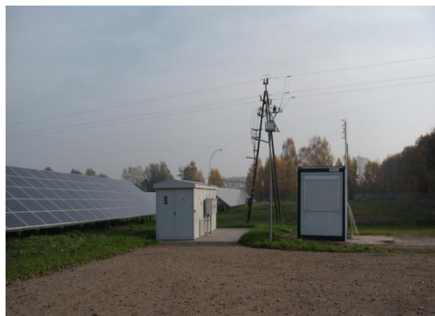
Fot.2. Kontener: stacja RSN 15 kV i transformator typ 15/0.38 kV oraz inwerter RDC 660 V
