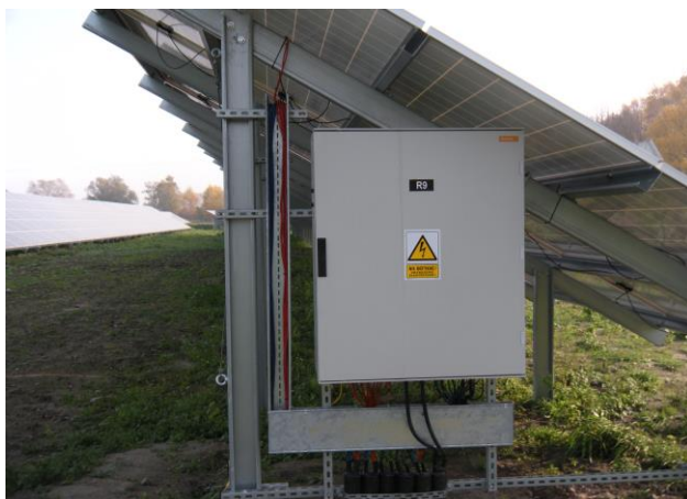
Fot.1. Widok string-box'a na ocynkowanej stalowej konstrukcji wsporczej
