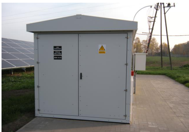
Fot.3. Kontener: stacja RSN 15 kV i transformator
