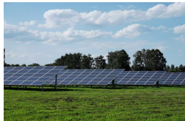
Fot. 4. Przykład zespołu paneli fotowoltaicznych w układzie pięciu rzędów poziomych
