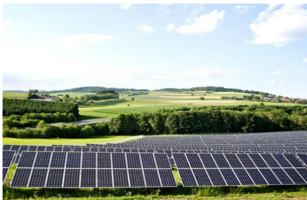
Fot. 3. Przykład zespołu paneli fotowoltaicznych w układzie dwóch rzędów pionowych
