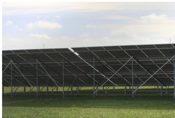
Fot. 2. Konstrukcja wsporcza z panelami fotowoltaicznymi – widok od tyłu
