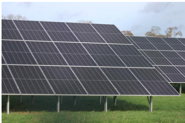
Fot. 1. Konstrukcja wsporcza z panelami fotowoltaicznymi - widok od strony paneli
