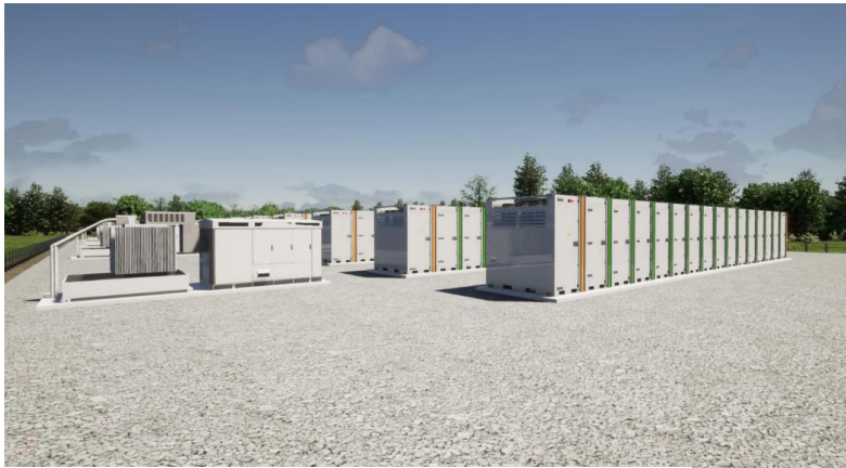
Rys. 4a. Przykład modułowego magazynu energii
