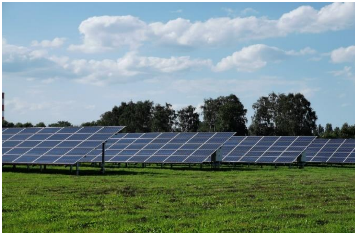
Fot. 2. Przykład zespołu paneli fotowoltaicznych w układzie pięciu rzędów poziomych
