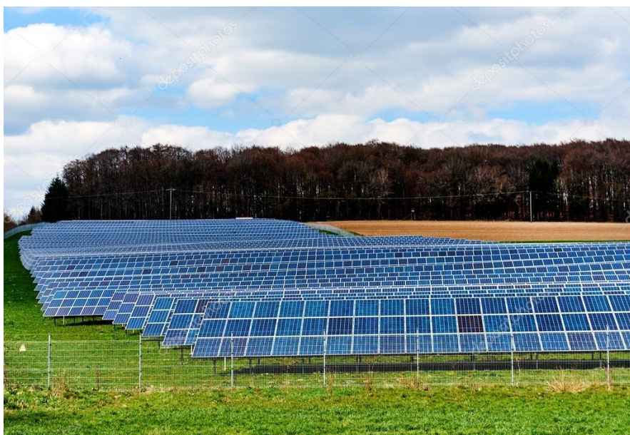
Fot. 14. Przykładowa farma fotowoltaiczna
