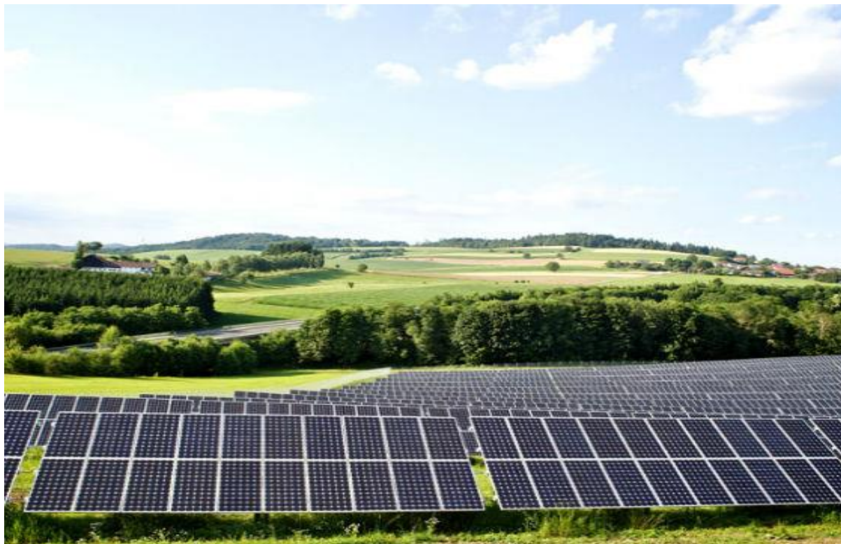
Fot. 1. Przykład zespołu paneli fotowoltaicznych w układzie dwóch rzędów pionowych
