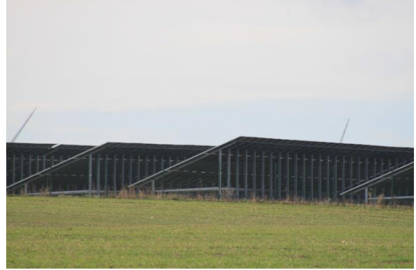
Fot. 34. Widok farmy fotowoltaicznej na terenie równinnym od tyłu
