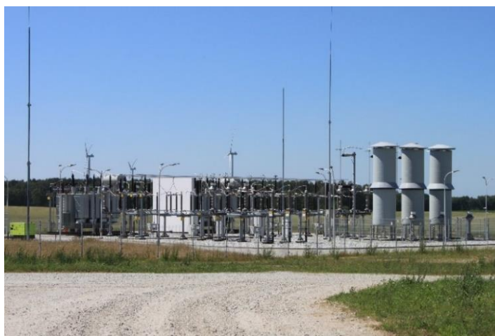
Fot. 29. Stacja ee GPO 15/110 kV FW „Biały Bór”
