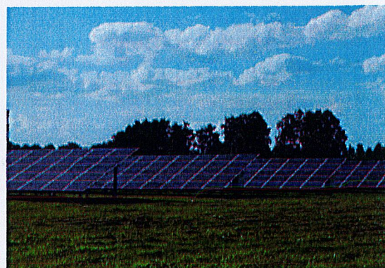
Fot. 2b. Przykład zespołu paneli fotowoltaicznych w układzie pięciu rzędów poziomych
