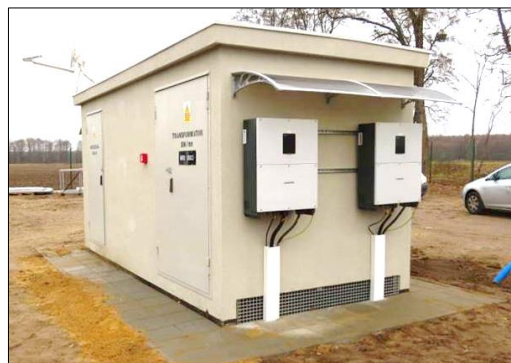
Pic. 7. Prefabrykowana stacja transformatorowa (pochodzenie: źródło własne).
