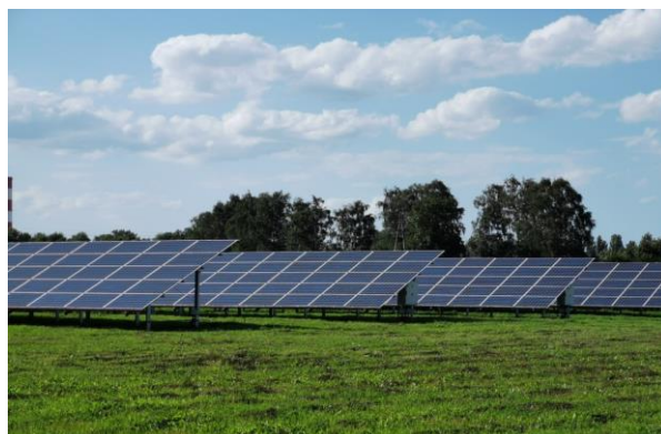
Fot. 2b. Przykład zespołu paneli fotowoltaicznych w układzie pięciu rzędów poziomych
