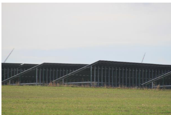
Fot. 17. Widok farmy fotowoltaicznej na terenie równinnym od tyłu
