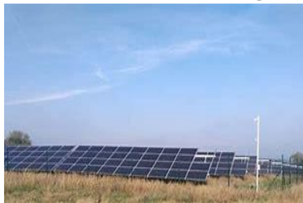
Fot. 16. Widok farmy fotowoltaicznej na terenie równinnym z kilkunastu m
