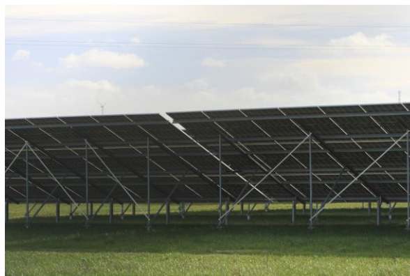
Fot. 1b. Konstrukcja wsporcza z panelami fotowoltaicznymi – widok od tyłu
