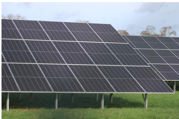
Fot. 1a. Konstrukcja wsporcza z panelami fotowoltaicznymi - widok od strony paneli
