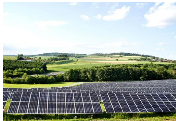
Fot. 2. Przykład zespołu paneli fotowoltaicznych – pionowy układ paneli w dwóch rzędach.
