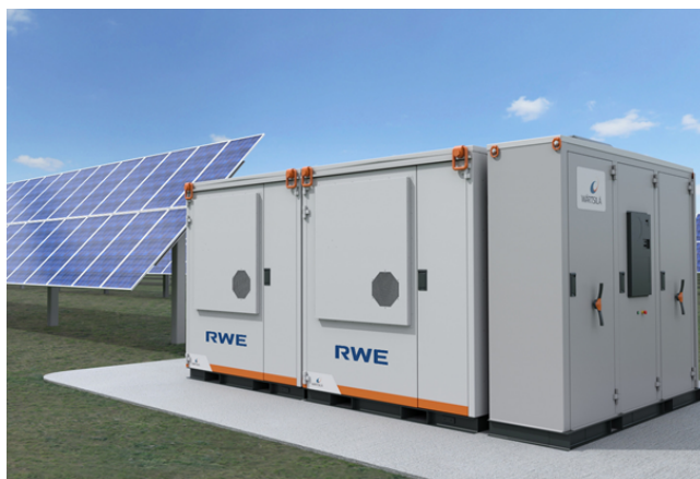
Rys. 3.4. Przykładowy magazyn energii
