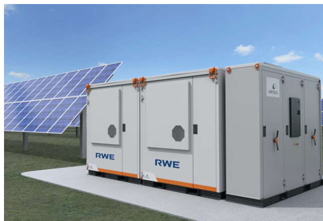
Rys. 3.4. Przykładowy magazyn energii
