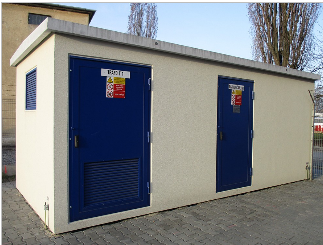
Rysunek 17. Przykładowa stacja transformatorowa
