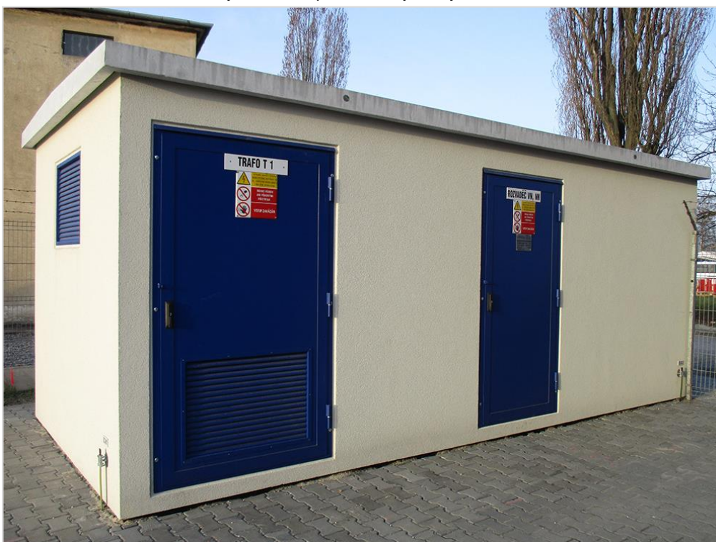
Rysunek 23. Przykładowa stacja transformatorowa
