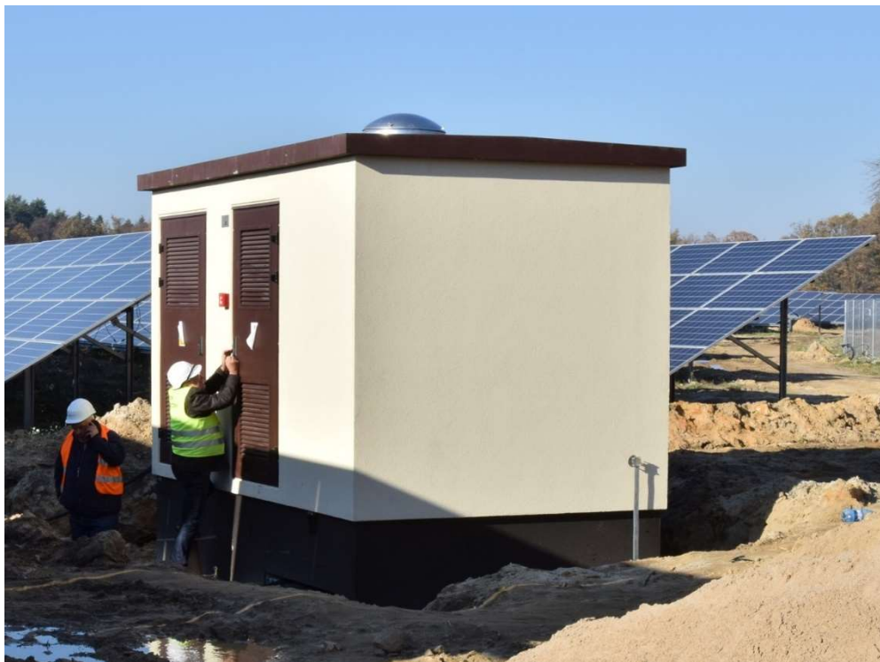
Przykładowa stacja kontenerowa
