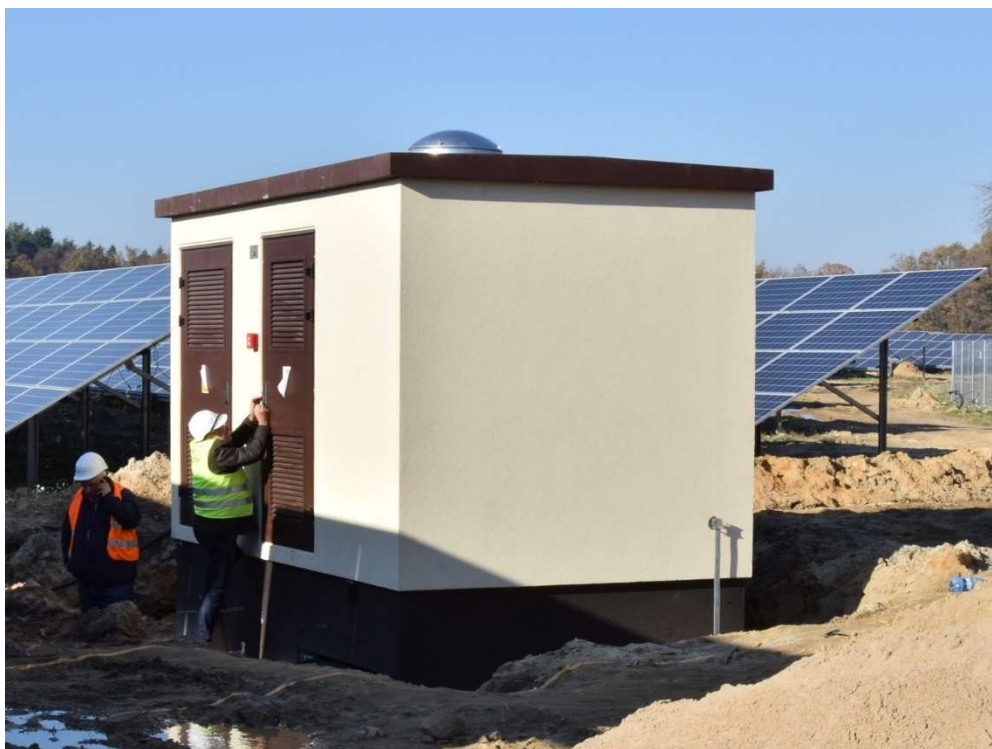
Przykładowa stacja kontenerowa
