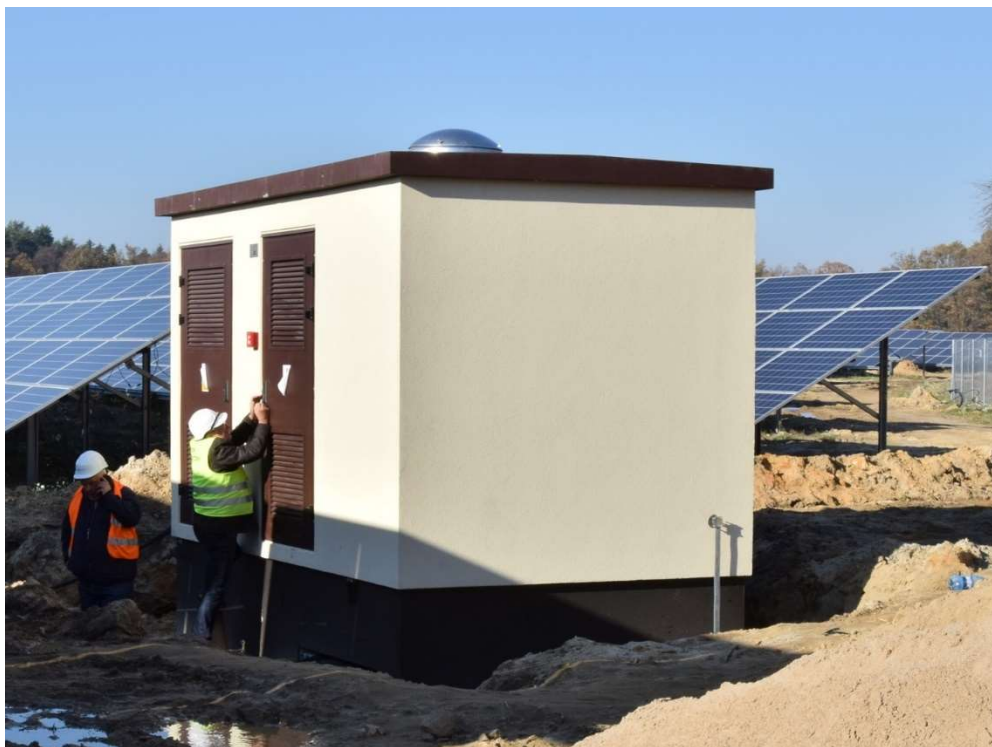
Przykładowa stacja kontenerowa
