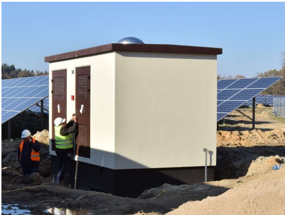
Przykładowa stacja kontenerowa
